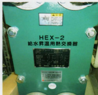
給水昇温用熱交換器
