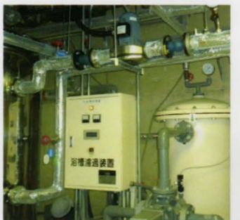
浴槽濾過装置
