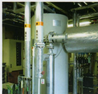
温水配管設備
