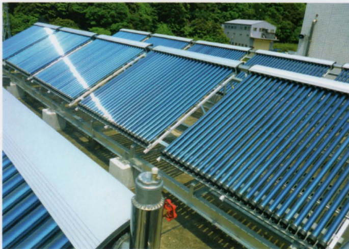
設置後の集熱器
