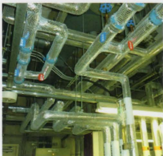
温水配管設備
